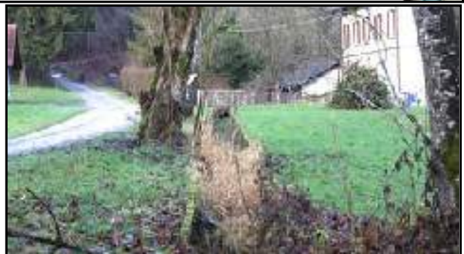
Im Gegensatz zum Kanalanfang ist dieser im Bereich der Gebäude noch intakt.
